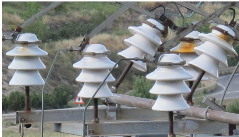
Grandes aisladores de porcelana en una torre eléctrica; Morella (2017)
